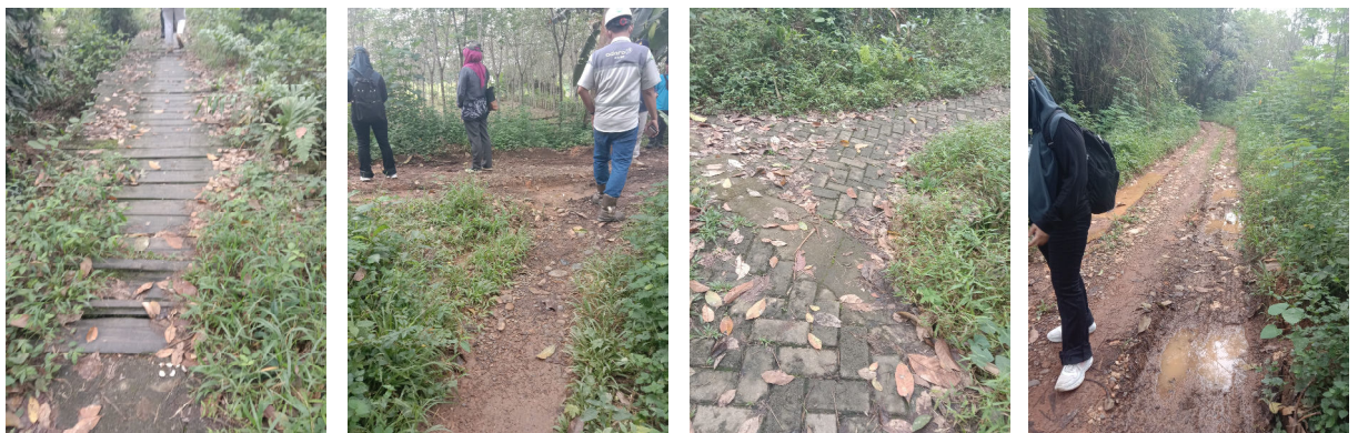
Gambar 4.14. Kondisi jalan usaha tani Sungai Batung Kecamatan Juai
